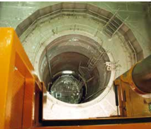
▼ Резервуар высокого давления
